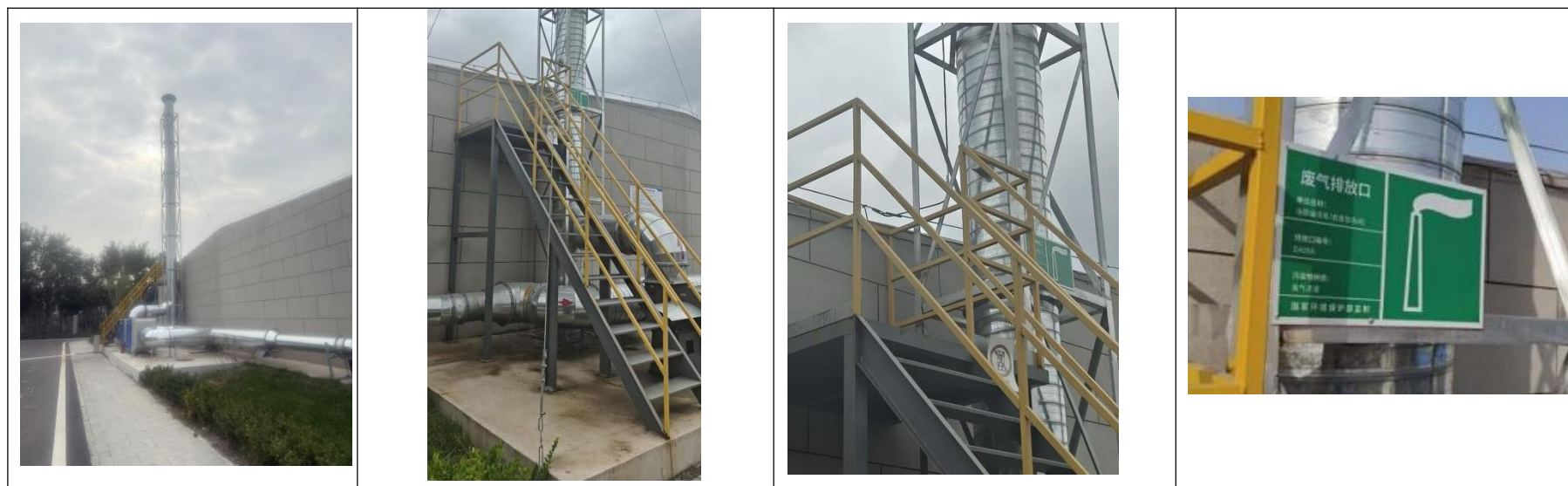
DA006 排气筒、扶梯、采样平台、采样口及标识牌
