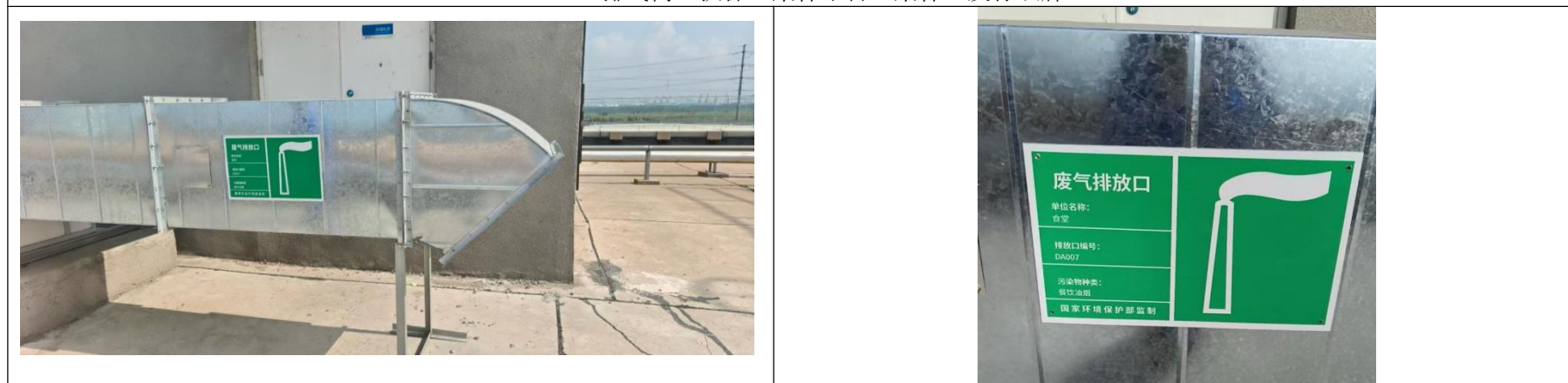
DA007 排烟管、采样口及标识牌
